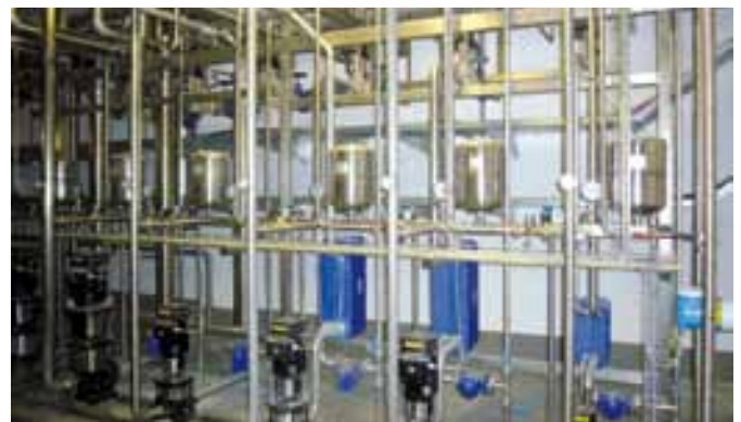
Teil der Prozessanlage (Heißwassererzeugung für Pasteure)
